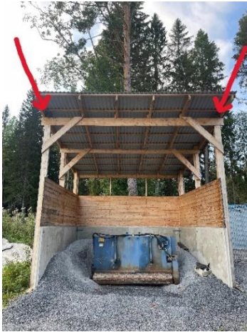
Figur 9. Tak över grusupplag där det förekommer två fågelbon på reglarna under taket.
