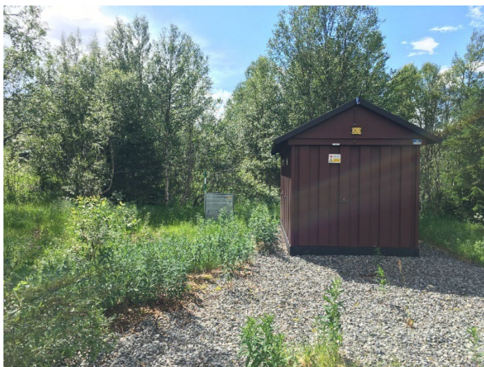
Figur 10. Foto av transformatorstation.
