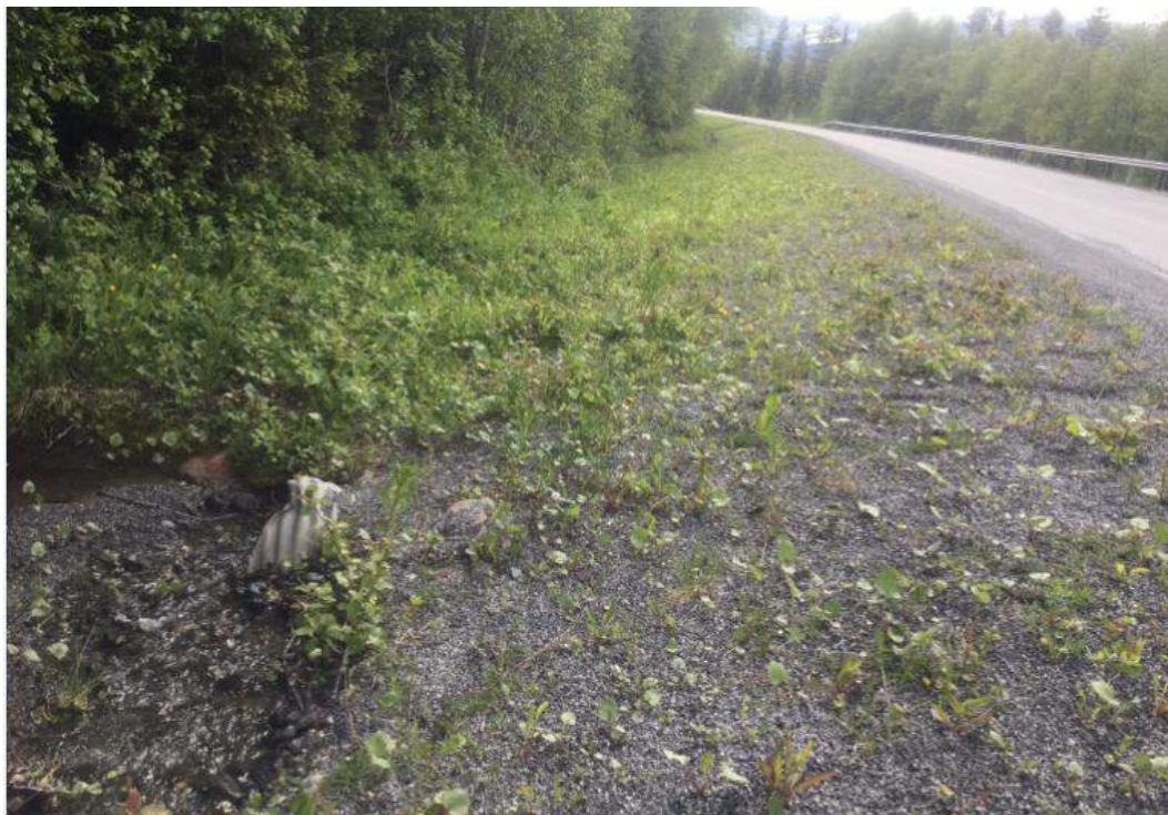
Figur 8. Trumma under Ullådalsvägen med upphöjd mark nedströms trummans inlopp. Trumman är dock till hälften igensatt med grus 10 .
