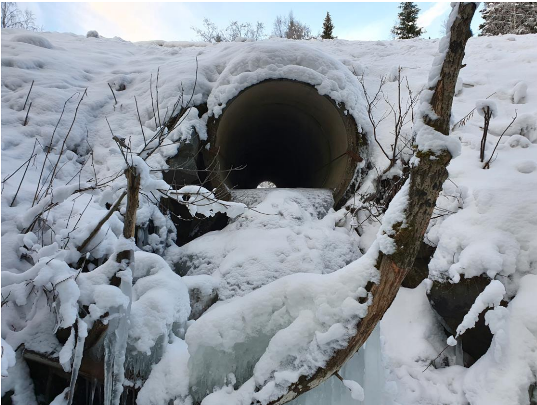
Figur 10. Dagvattentrumma genom E14 som obesörjer den östra bäckfåran. Dimension 1000 mm.
